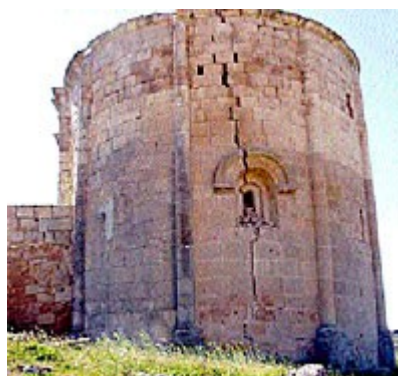
Las imágenes demuestran el estado de deterioro en el que se encuentra la iglesia románica de Villaescusa de Palositos. Imágenes tomadas de www.villaescusadepalositos.com
